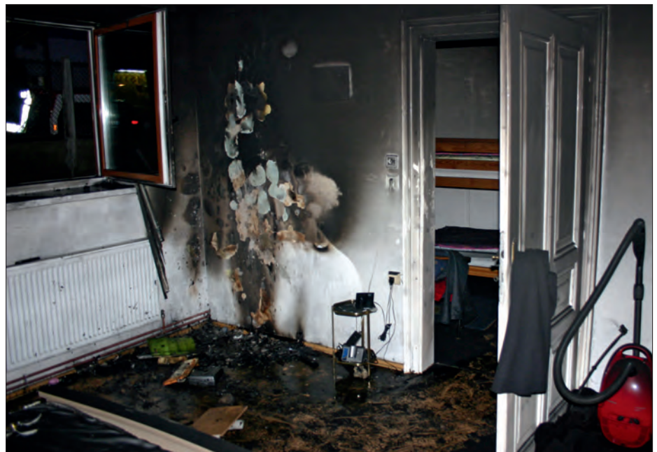
Wohnung in Tulln durch Brand verwüstet
