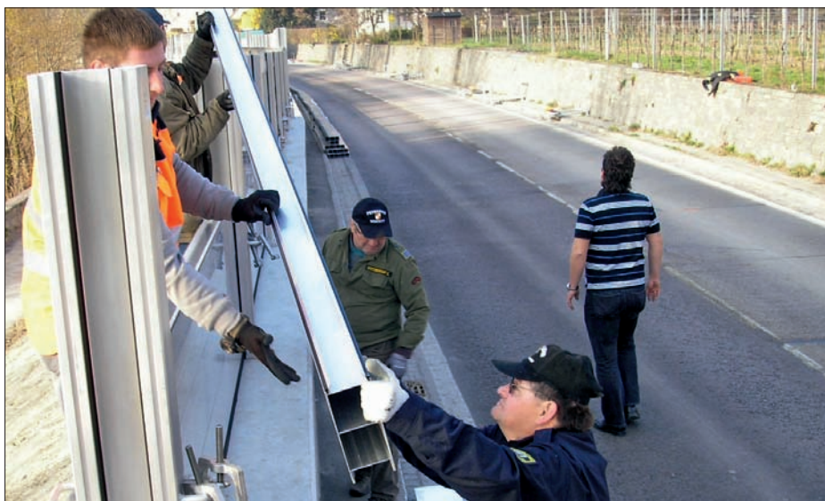
Nur mehr wenige Teile fehlen im Hochwasserschutz-„Puzzle“
