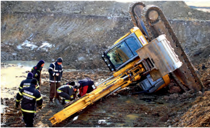
Zu einem spektakulären Bergeinsatz wurde die FF Wiener Neustadt auf eine Baustelle nach Netting alarmiert. Bei Aushubarbeiten war der Bagger in eine Baugrube gestürzt. Der Fahrer wurde zum Glück nur leicht verletzt.
