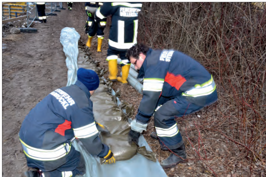
Feuerwehrmitglieder errichteten in Windeseile einen Damm aus Sandsäcken, um eine Überflutung zu verhindern
