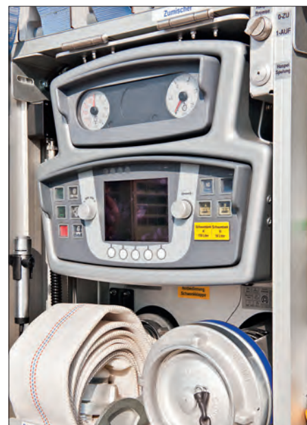
Der Pumpenbedienstand befindet sich im Geräte-raum 4
