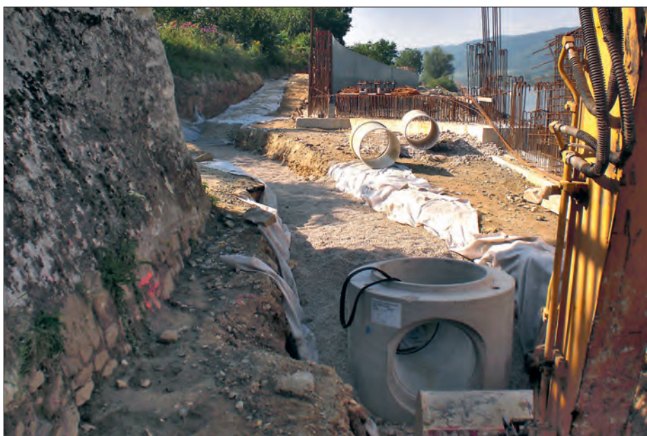
Hier ebenfalls ein Drainagerohr hinter dem Hochwasserschutz
