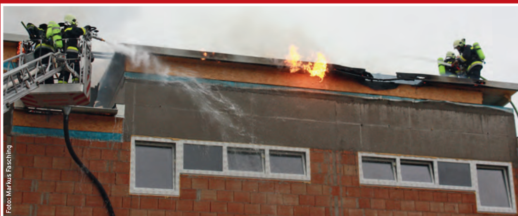
Krems-Lerchenfeld - Im Zuge der Bauarbeiten kam es im Bereich der Dachfläche zu einem Brandausbruch. Atemschutztrupps mussten in mühevoller Kleinarbeit die Verblechung öffnen, um an den Brandherd zu gelangen.
