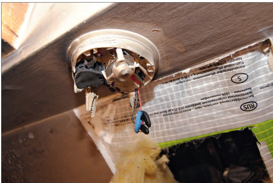
Dieser Rauchmelder alarmierte – er muss jetzt erneuert werden. Eine minimale Investition im Vergleich zu dem, was verhindert werden konnte
