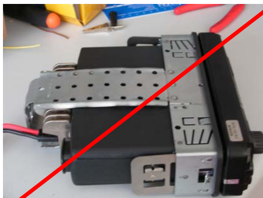
Keinesfalls sollte es beim Einbau so aussehen !!
